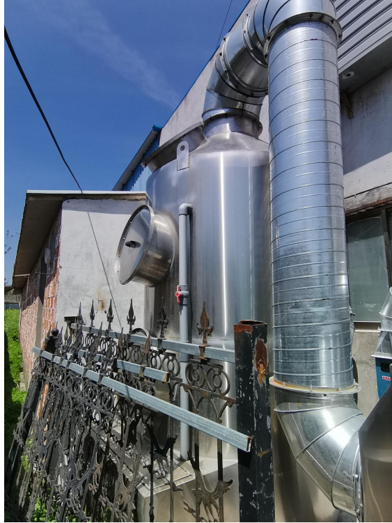
提标升级改造前的喷淋装置
